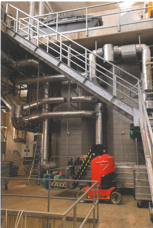
In der Technikzentrale sind Zugänge für Wartung und Monitoring der Versorgungskreise untergebracht.
