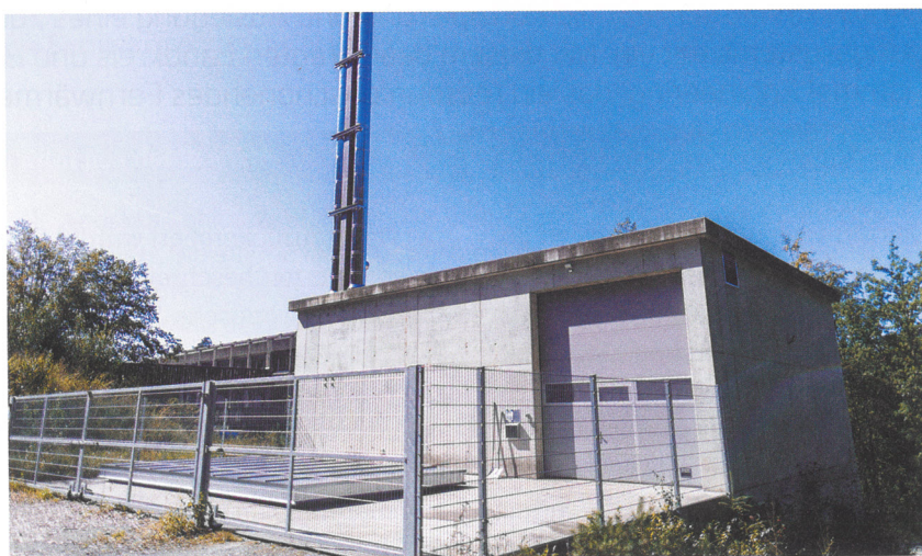
Bild 1. In der Technikzentrale wird aus Waldrestholz Wärme erzeugt und von dort über ein Fernwärmenetz zu den Gebäuden transportiert
