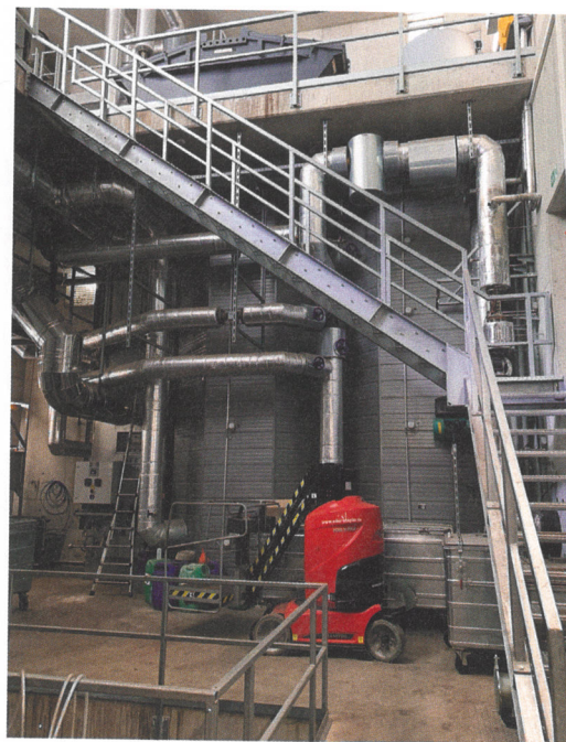
Bild 2. In der Technikzentrale sind Zugänge für Wartung und Monitoring der Versorgungskreise untergebracht
