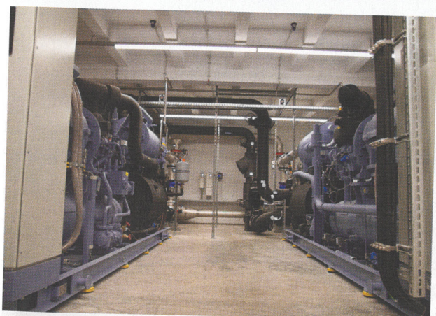
Die Kälte wird mit zwei Kompressionskältemaschinen von je 1,2 MW Kälteleistung erzeugt. Zwei Gas-Heizkessel mit je 900 kW Leistung sorgen für die Wärme.
