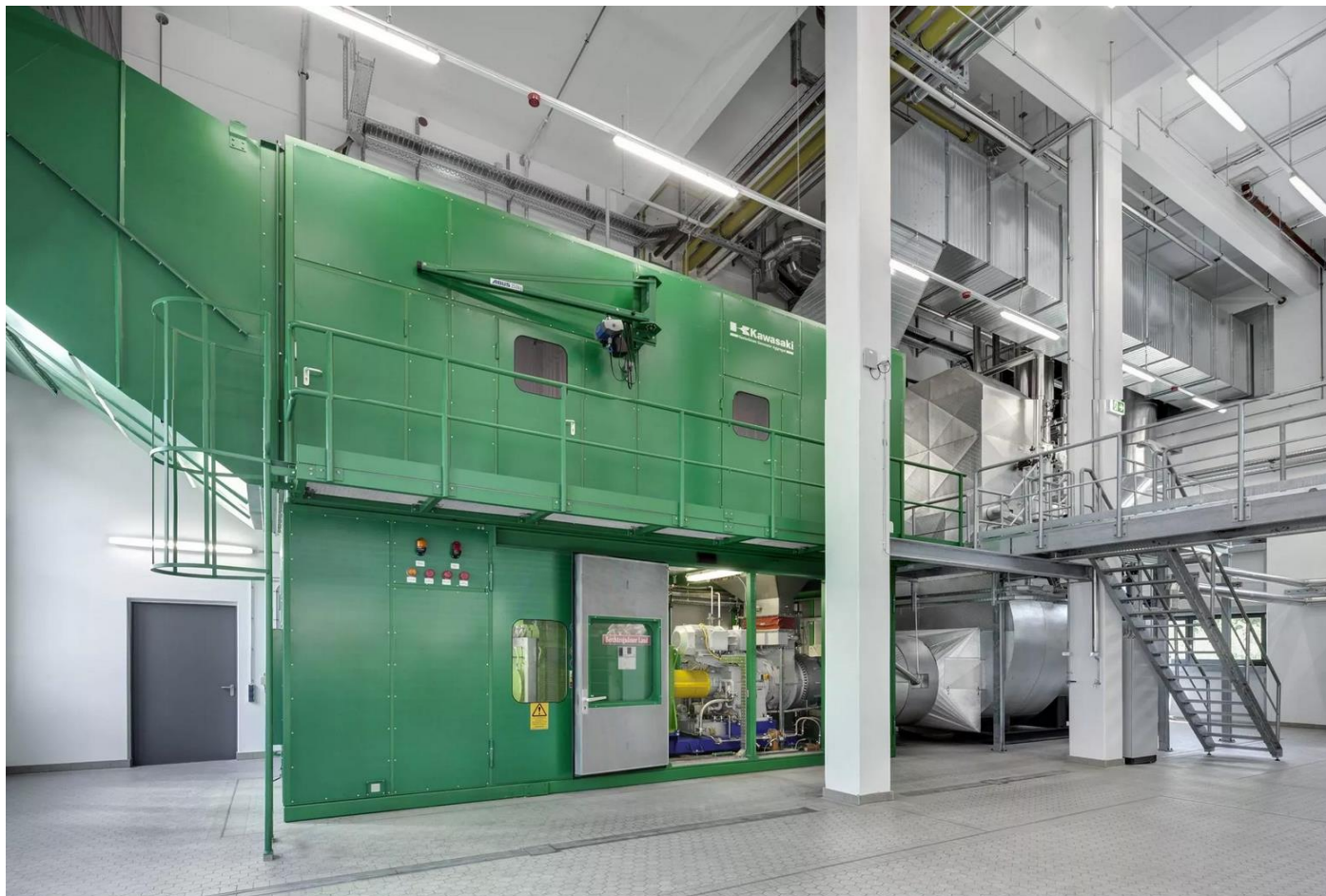
Eine hocheffektive Gasturbine – die auch mit Bio-Erdgas betrieben werden kann und H2-ready, also für Grünen Wasserstoff vorbereitet ist – versorgt die Produktion mit Dampf, Wärme und Strom. Quelle: Gammel Engineering GmbH
