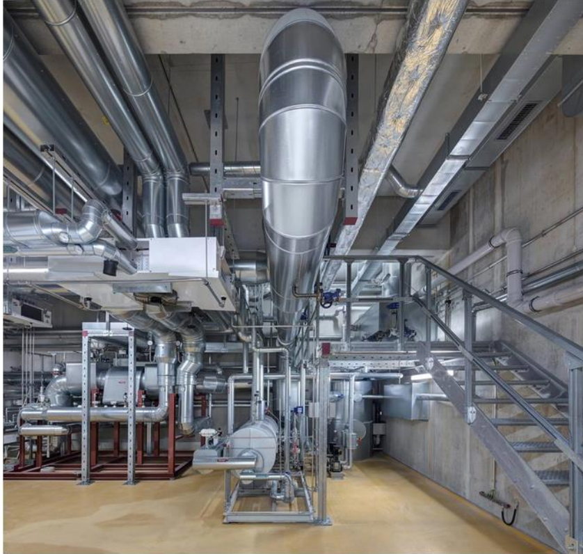
Zwei Satteldampfkessel mit Zweistoffbrennern (Öl/Gas) können mit jeweils 10 t/h den Spitzenlast-Dampfbedarf abdecken. Quelle: Gammel Engineering GmbH
