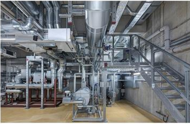
Das Biomasseheizkraftwerk der Naturenergie Cham, an dem Gammel beteiligt ist, liefert der Käserei Prozesswärme aus regenerativen Hackschnitzeln.
