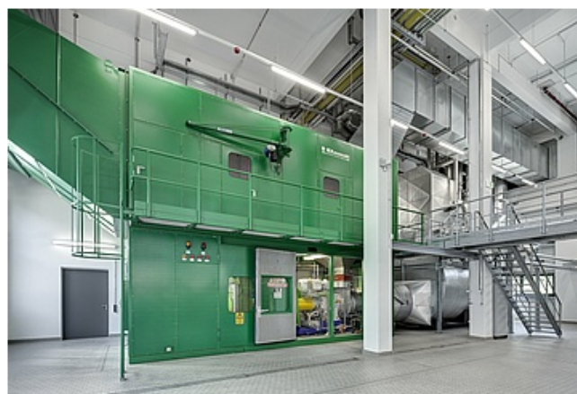
Eine hocheffektive Gasturbine – die auch mit Bio-Erdgas betrieben werden kann und H 2 -ready, also für Grünen Wasserstoff vorbereitet ist - versorgt die Produktion mit Dampf, Wärme und Strom.
