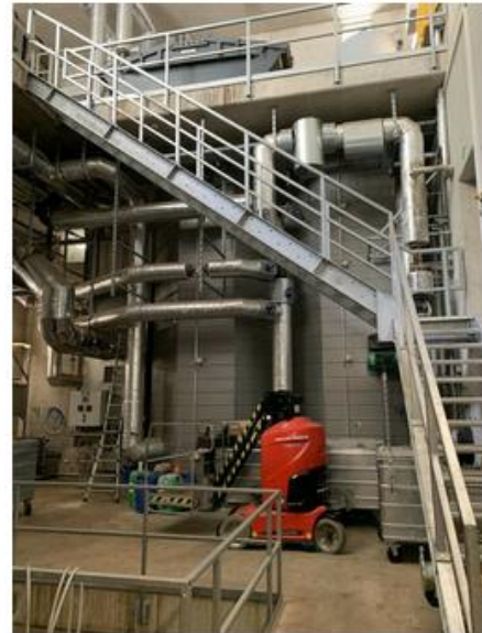
In der Technikzentrale sind Zugänge für Wartung und Monitoring der Versorgungskreise untergebracht. © Gammel Engineering
