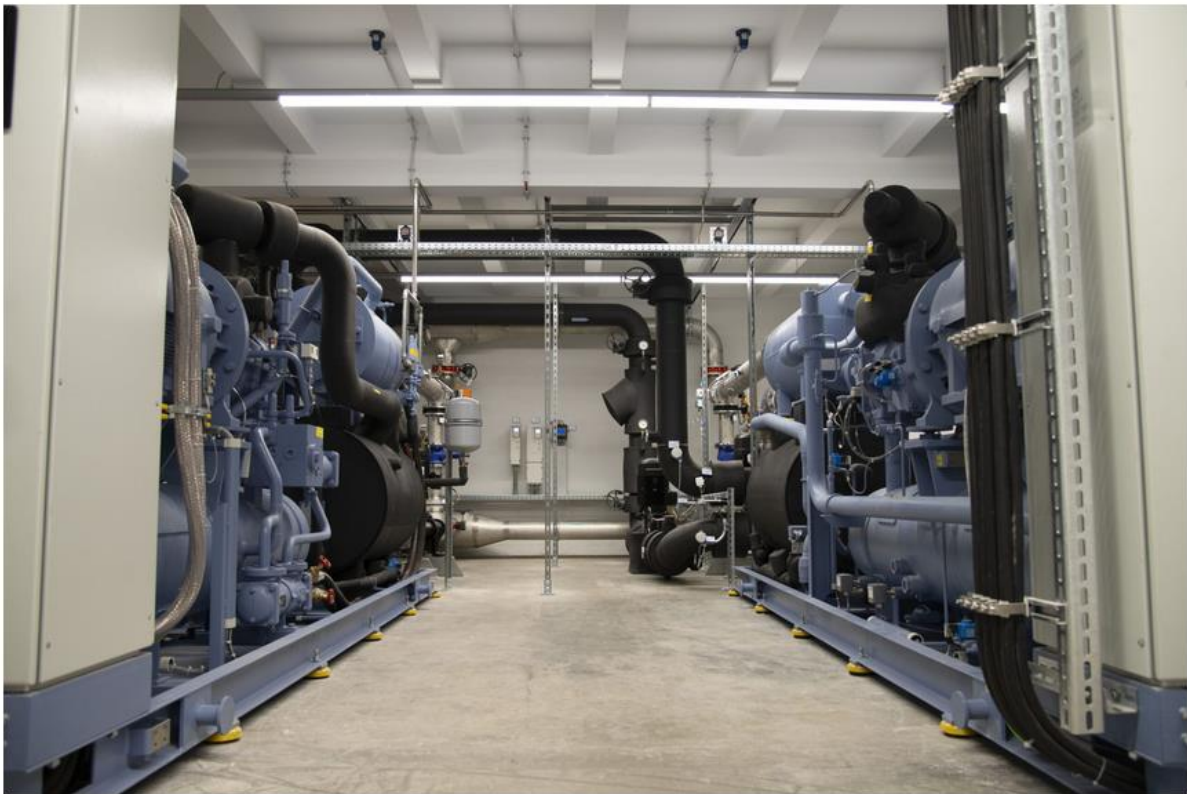
Die Kälte wird mit zwei Kompressionskältemaschinen von je 1,2 Megawatt Kälteleistung erzeugt, zwei Gas-Heizkessel mit je 900 Kilowatt Leistung sorgen für die Wärme. Foto: Emuge
