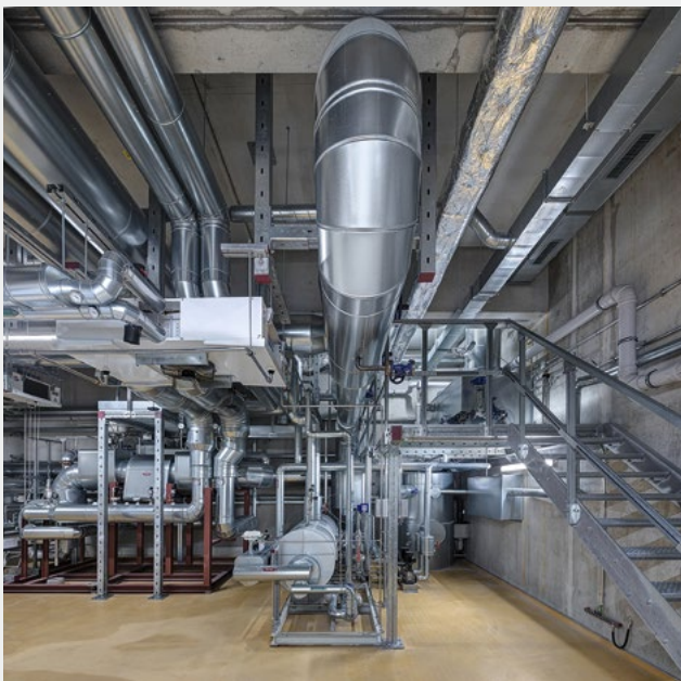
Fig. 3 Das Biomasseheizkraftwerk der Naturenergie Cham liefert der Käserei Prozesswärme aus regenerativen Hackschnitzeln.
