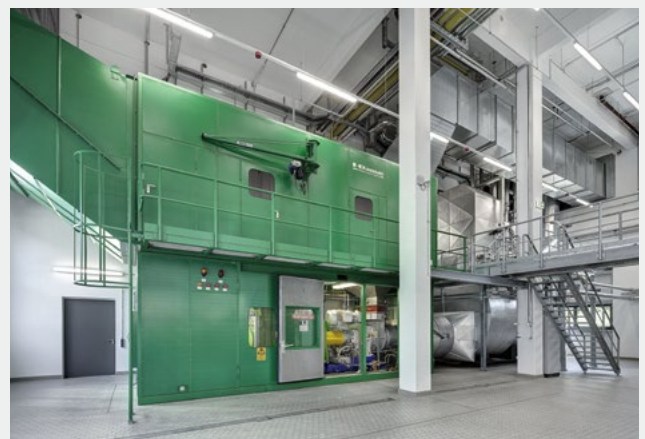
Fig. 1 Eine hocheffektive Gasturbine versorgt die Molkerei mit Dampf, Wärme und Strom. Die Turbine kann auch mit Biomethan betrieben werden und ist zudem H 2 -ready – also vorbereitet für Grünen Wasserstoff.
