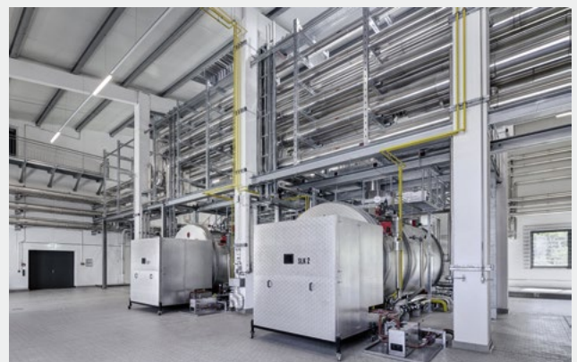
Fig. 2 Zwei Satteldampfkessel mit Zweistoffbrennern (Öl/Gas) können mit jeweils 10 t/h den Spitzenlast-Dampfbedarf abdecken.
