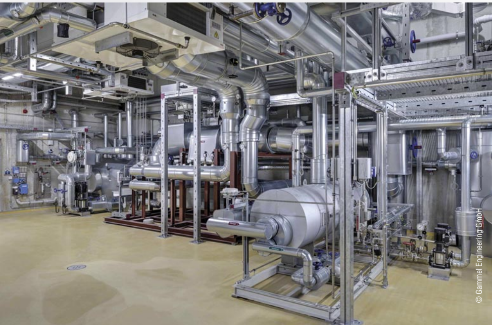
Das von Gammel Engineering konzipierte Energiekonzept inklusive modernem Technikhaus ermöglicht eine flexible Dampfversorgung
