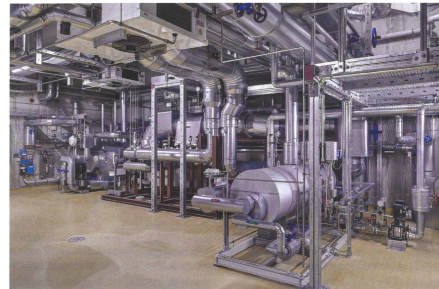
Das von Gammel Engineering konzipierte Energiekonzept inklusive modernstem Technikhaus ermöglicht eine flexible Dampfversorgung.
