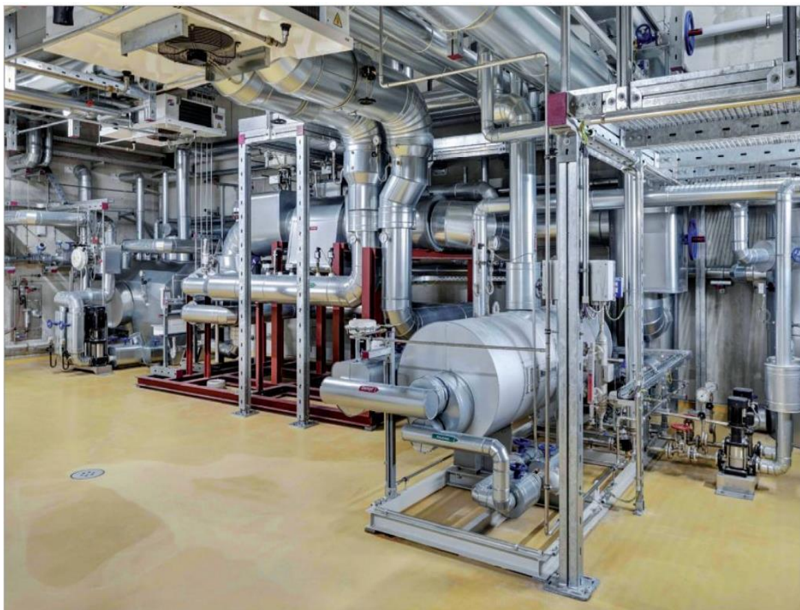
Das von Gammel Engineering konzipierte Energiekonzept inklusive modernstem Technikhaus ermöglicht eine flexible Dampfversorgung.
