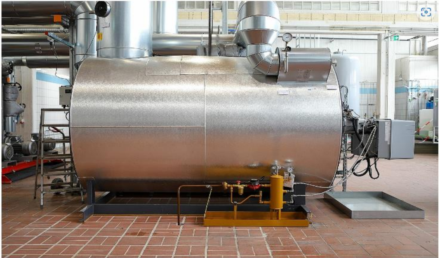
Zwei Spitzenlast-Warmwasserkessel mit je 4.000 kW sichern die Versorgung bei erhöhtem Bedarf.
