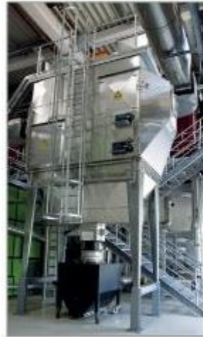
Durch die kontrollierte Verbrennung entsteht Prozesswärme als Dampf, der über ein spezielles Leitungssystem zu den verschiedenen Prozessstationen auf dem Brauergelände geführt wird. Fotos: Gammel Engineering GmbH
