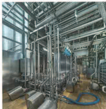
Bild 2: Nach Installation aller neuen Komponenten erfolgte eine abschließende Verbindung zwischen den bestehenden Prozessdampfinstallationen und den BHKW-relevanten Komponenten zu einem Gesamtsystem, sodass auch Prozesse wie die Wasseraufbereitung oder Entgasung in das neue Energienetz eingebunden sind. Bild: Gammel Engineering GmbH
