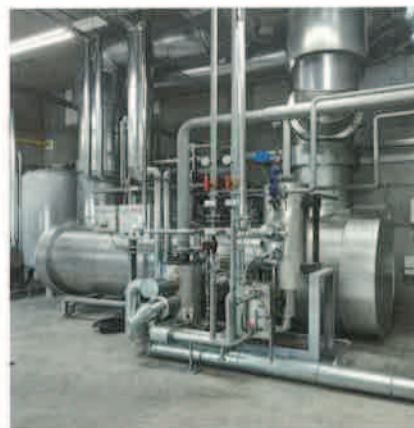
Bild 3: Über den Dampfboiler wird aus dem Dampferzeugungsprozess entstandene Abwärme zurückgewonnen und für den Energiekreislauf der Milchwerke nutzbar gemacht. Bild: Gammel Engineering GmbH
