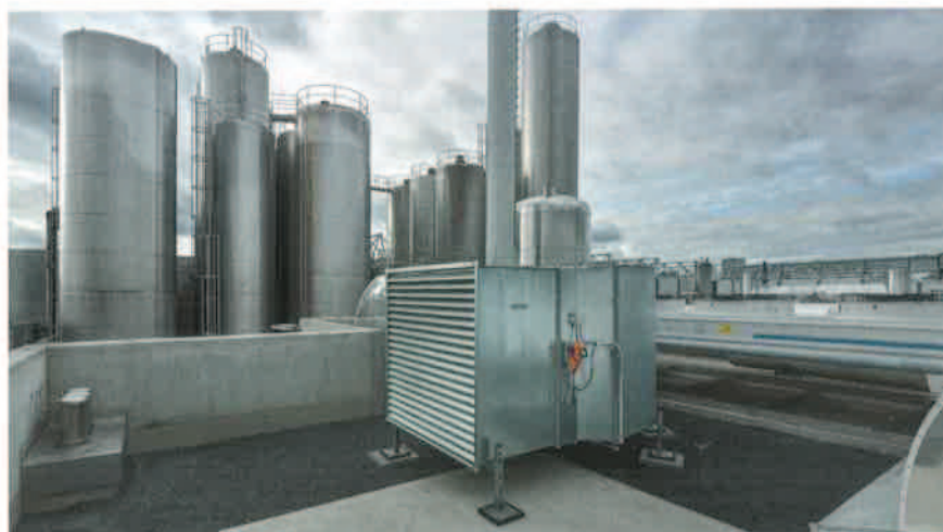
Bei der Milchwerke Oberfranken West eG wurde ein eigenes BHKW installiert und in ein dampfbasiertes Prozesswärmesystem eingebunden. Bild: Gammel Engineering GmbH
