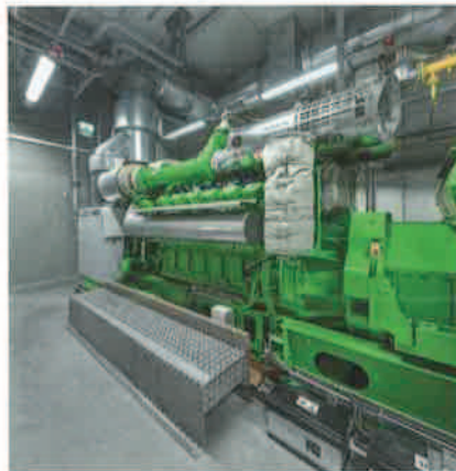
Bild 1: Ein neues BHKW dient zur Erzeugung von Strom, Wärme und Dampf sowie zur Warmwasseraufbereitung für die Pasteurisierung. Bild: Gammel Engineering GmbH
