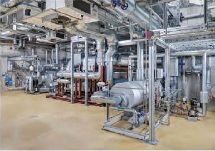
■ Ein Reindampferzeuger mit einer Leistung von 500 kg/h wandelt den Dampf in Reindampf für Prozesse um; ein Heizkondensator generiert 95 °C helles Wasser zum Heizen.
