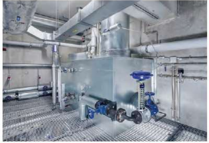
■ Ein Wärmetauscher mit einer besonders grossen Tauscherfläche wurde installiert, um einen besseren Wärmeübergang ohne Druckverlust zu erzielen.
