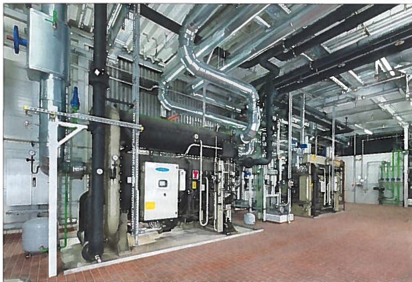
Bild 1. In der Energiezentrale des BMW-Group-Werks Landshut wurden zwei Absorptionskältemaschinen errichtet, die sich aus dem zentralen Wassernetz speisen und die Abwärme aus den Schmelzöfen nutzen, um Kälte zu erzeugen
