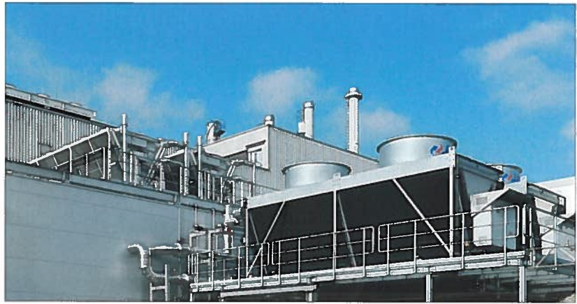
Bild 2. Moderne hybride Trockenkühler ergänzen das Energiekonzept im BMW-Group-Werk Landshut
