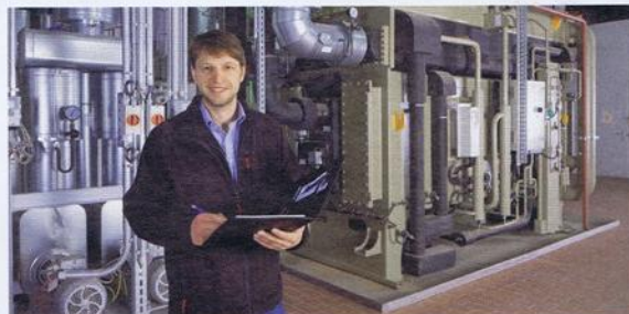
Am Standort Landshut wird die Abwärme aus der Schmelzerei nun in das werksinterne Heißwassernetz eingespeist. In Kombination mit der neuen, dritten Kraft-Wärme-Kopplungsanlage auf dem Werksgelände entsteht so ein nachhaltiger Energiekreislauf. „Mit den Absorptionskältemaschinen kann sich das Energiesystem dynamisch an Schwankungen bei Produktion oder Außentemperatur anpassen“, erklärt Projektleiter Florian Prantl von Gammel Engineering.
