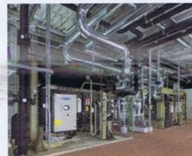
In der Landshuter Leichtmetallgießerei kommt jeden Arbeitstag rund 740 Grad Celsius heißes Flüssigaluminium zum Einsatz, z.B. zur Herstellung von Kurbelgehäusen oder Zylinderköpfen. Die Abwärme der Schmelzöfen wird nun aufgefangen und im Winter zur Gebäudeheizung herangezogen. Im Sommer wiederum versorgt sie eine sogenannte Absorptionskältemaschine (im Bild), mit deren Hilfe Kälte für verschiedene Fertigungsprozesse im Werk erzeugt wird.
