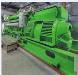
Auch die neue Kraft-Wärme-Kopplungsanlage, die aus Erdgas Strom und Wärme generiert, speist die Absorptionskältemaschine mit Wärme. Zudem macht sie den Standort ein weiteres Stück autarker. Bilder: Gammel
