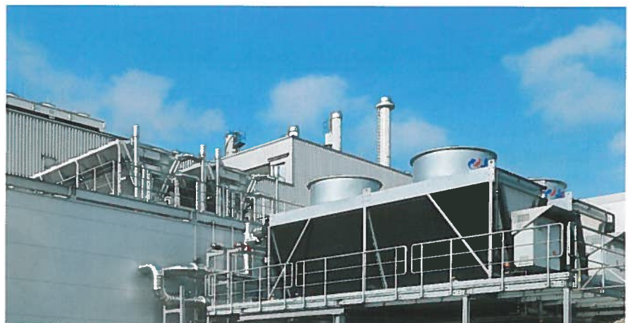
Moderne hybride Trockenkühler ergänzen das Energiekonzept im BMW Group Werk Landshut. Quelle: Gammel Engineering
