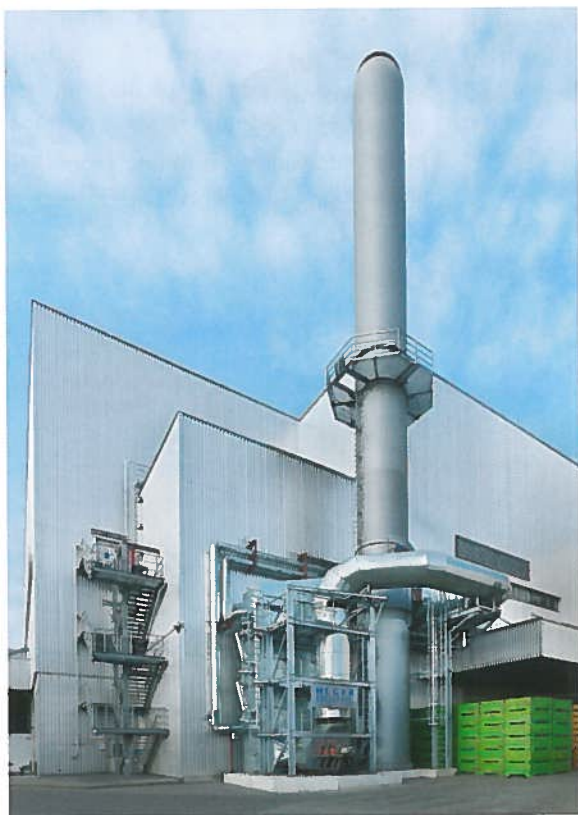
Im Rahmen eines Energie-Einspar-Contractings beauftragte die BMW Group die Unternehmen Siemens, Müller und Gammel Engineering für das Werk in Landshut, ein neues Energiekonzept zu erstellen, das unter anderem die Abwärme aus den Schmelzöfen zur Kälteerzeugung nutzt. Quelle: Gammel Engineering
