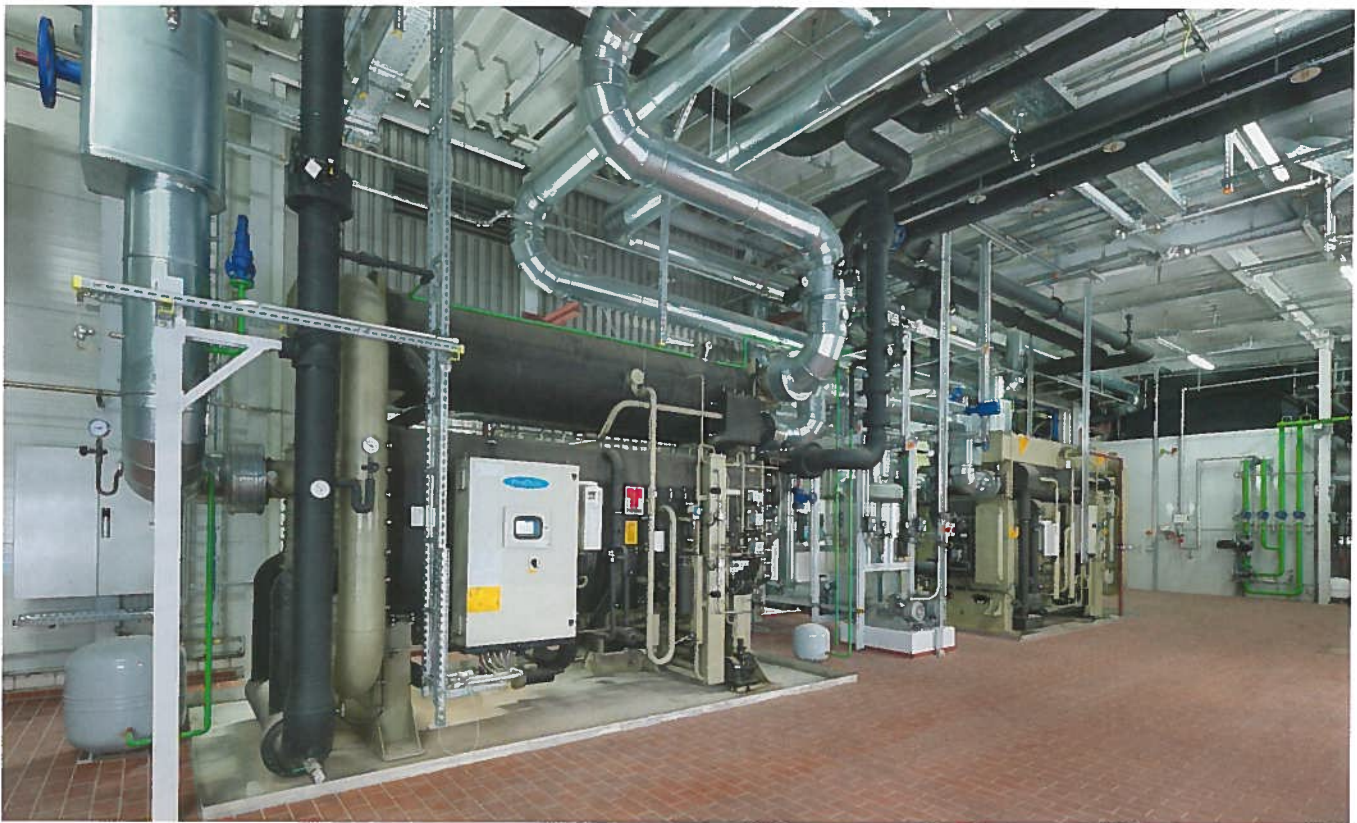
In der Energiezentrale des BMW Group Werks Landshut wurden zwei Absorptionskältemaschinen errichtet, die sich aus dem zentralen Wassernetz speisen und die Abwärme aus den Schmelzöfen nutzen, um Kälte zu erzeugen. Quelle: Gammel Engineering
