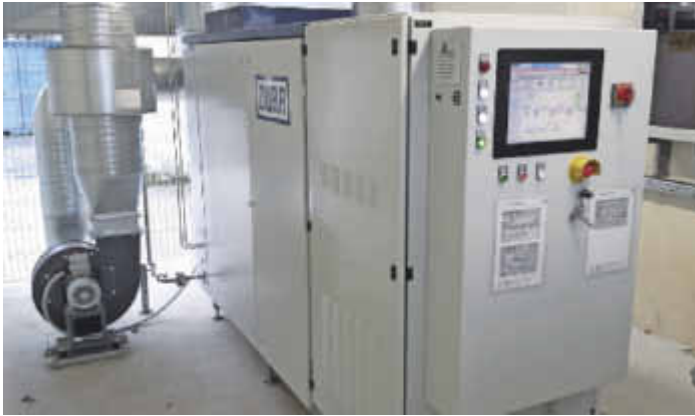
Die Stromerzeugungseinheit aus Dürr-Mikrogasturbine und Generator. Die Mikrogasturbine wird von den Stadtwerken Haßfurt betrieben.
