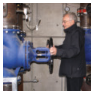
Bürgermeister Dr. Klaus Bühler öffnet den Schieber: Die Wärmelieferung der Gemeinde an die Firma HILTI beginnt
