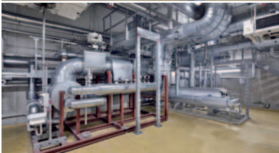
Ein Reindampferzeuger mit einer Leistung von 500 kg/h wandelt den Dampf in Reindampf für Prozesse um; ein Heizkondensator generiert 95 °C heißes Wasser zum Heizen. (Fotos: Gammel Engineering GmbH)
