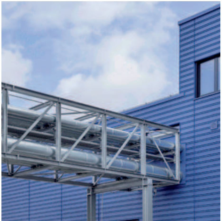
Die Rohrbrücke schließt direkt am Technikhaus an und führt den Dampf innen ins Untergeschoss zur Aufbereitung.
